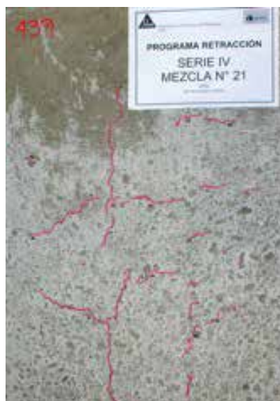
Figura 2. Concreto 4000 psi a las 24 hrs, expuesto a viento de 2 m/s
