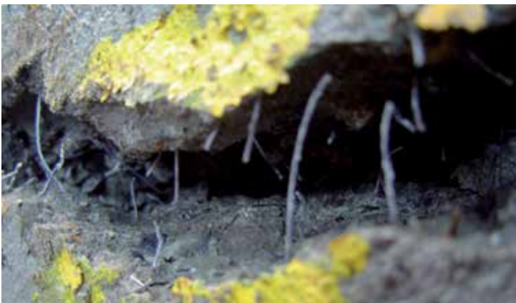
Interior de la falla, nótese las fibras perpendiculares al plano de falla cuyo anclaje se perdió.
