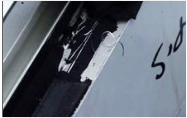
Figura 32: Ejemplo con la junta negra del SG - Fallo de adhesión.
