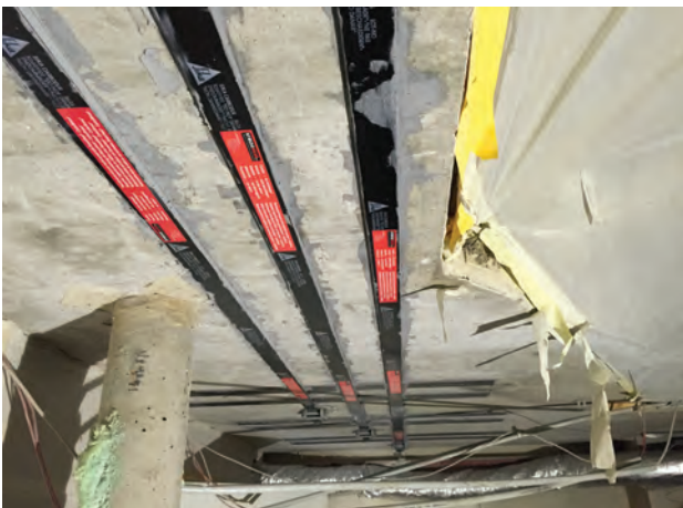
Foto 15. Platinas de carbono postensadas en la losa de un edificio en Viena (Austria)
