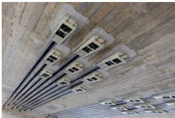
Foto 17. Extremo móvil del sistema de platinas de carbono postensadas (zona donde se coloca el gato hidráulico para la aplicación de la fuerza de tensado), en un puente en Suiza.
