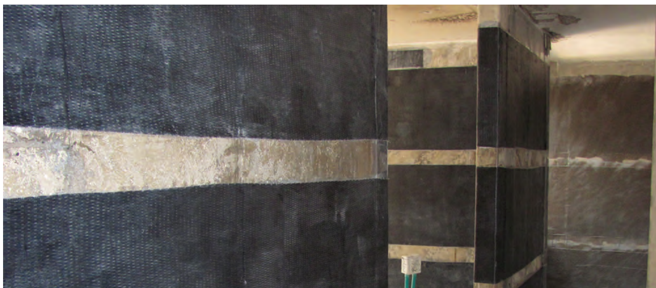
Foto 10. Muros de concreto reforzados con laminados de fibra de carbono SikaWrap® 600C , para aumentar su capacidad de soportar fuerzas cortantes durante un sismo.
