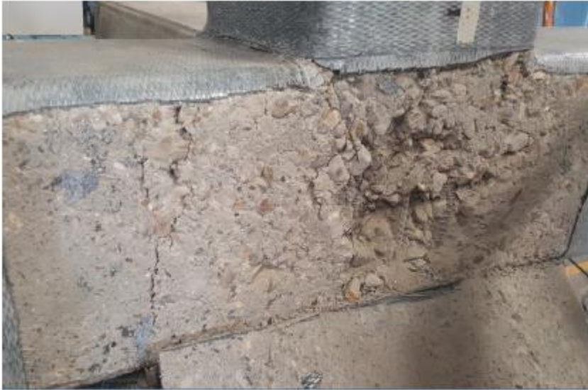
Figura 3-8: Falla localizada en viga y gran deterioro en zona del nudo (FRP-2)
