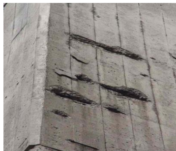
Deterioro en el tiempo, incendio, impacto, etc.
