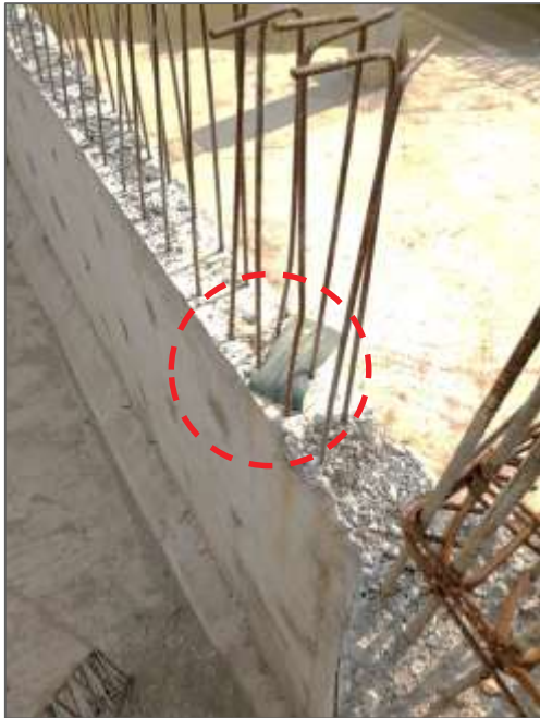
La cinta de PVC no quedó centrada en el muro
