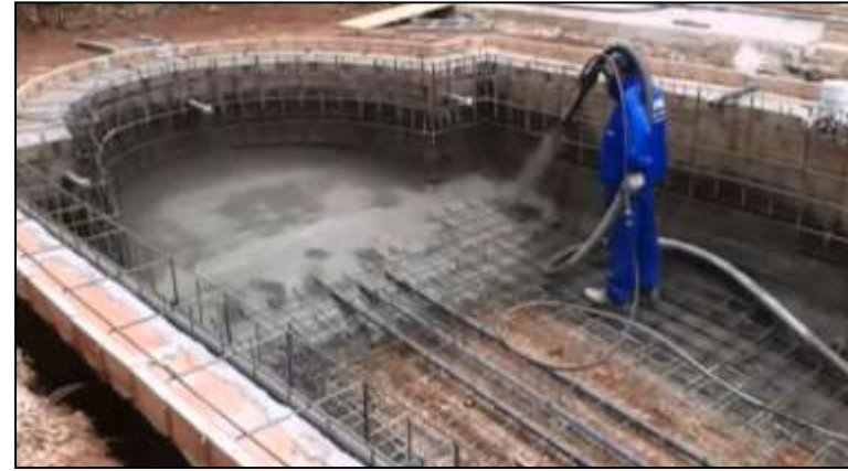
Secciones y acero insuficientes
