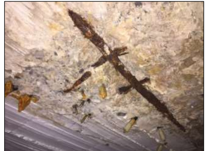
Corrosión en la losa
