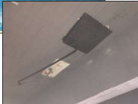
Bandeja metálica para detener las filtraciones
