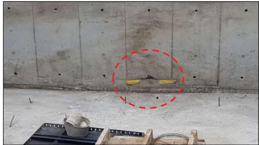
La cinta de PVC quedó en la parte externa del muro en lugar de en el centro
