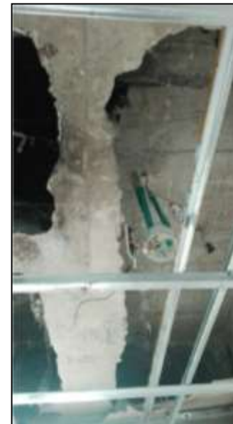
Viguetas de sección irregular y tubería atravesando la losa
