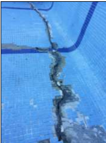
Fisuras en las losas y muros
