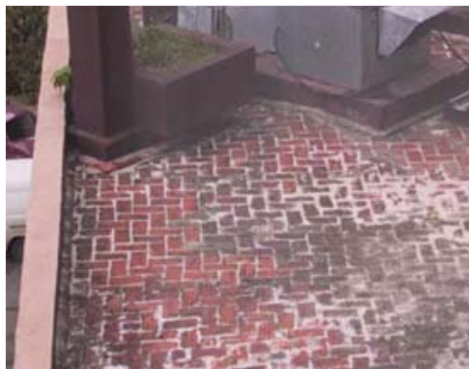
Típica cubierta que puede presentar con el tiempo problemas de permeabilidad cuya solución no es fácil y generalmente implica retirar el piso de baldosas.
