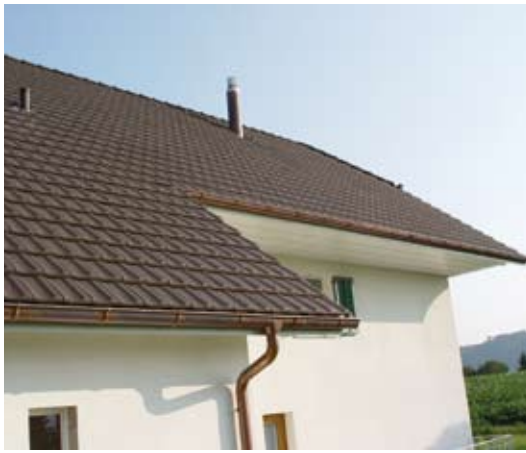
Fachadas protegidas por el generoso alero del techo el cual cuenta, además, con muy buenas canales y bajantes.
