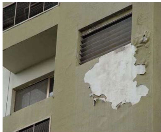
Fachada donde el recubrimiento falló por adherencia y baja resistencia al paso de agua lluvia.
