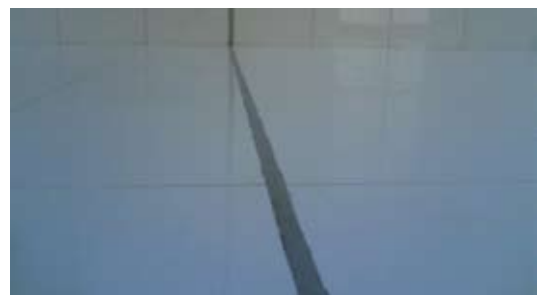
Junta de dilatación de una piscina con su correspondiente sello elástico.
