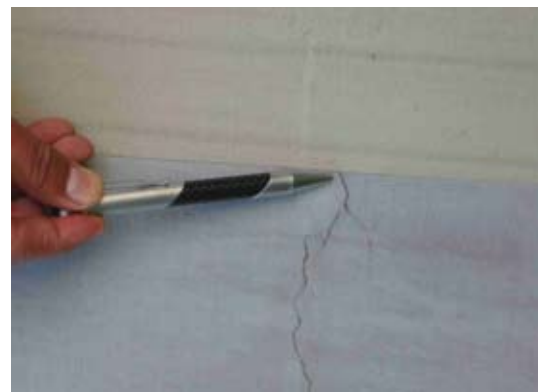
Empleo de un recubrimiento elástico, barrera de CO 2 e impermeable al agua, para proteger exteriormente un tanque fisurado. Nótese que el recubrimiento no copia la grieta. ( SikaColor®555 W )
