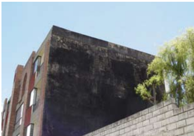
Culata de una edificación protegida contra la humedad con un recubrimiento asfáltico. Se aprecia la necesidad de un repinte.
