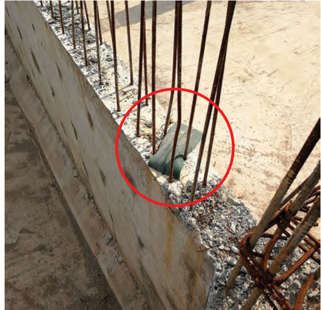
Cinta de PVC mal centrada en el muro de un tanque.
