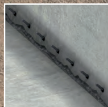
Filtraciones en juntas de construcción
