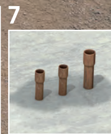
Filtraciones en pasantes de tuberías
