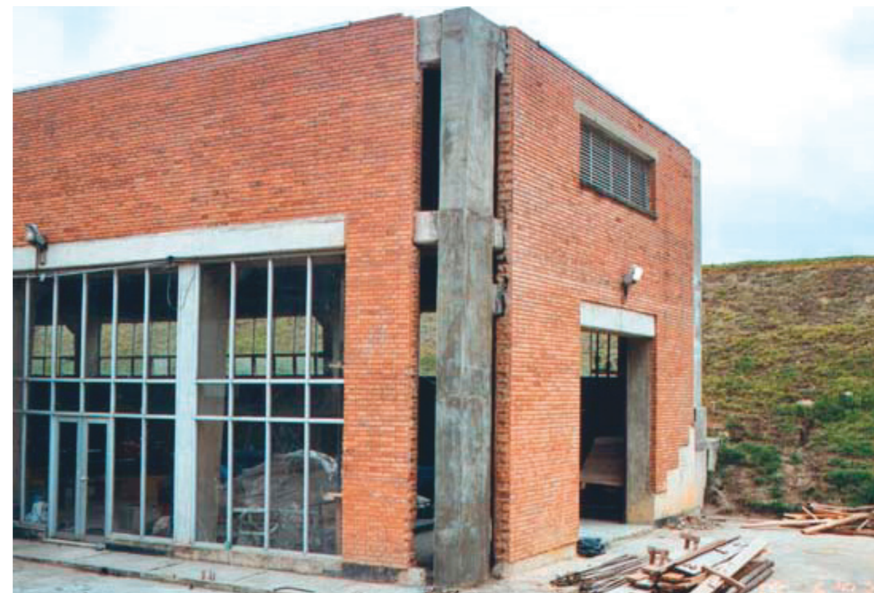
Encamisado de columna con concreto listo de baja retracción en edificio industrial
