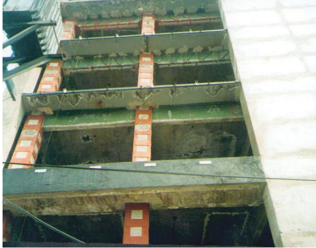
Angulos y platinas metálicas en columnas y vigas de edificio de oficinas
