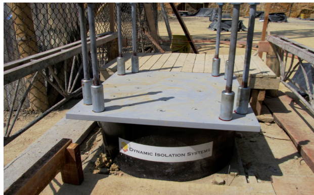
Aisladores en edificio (Colombia)
